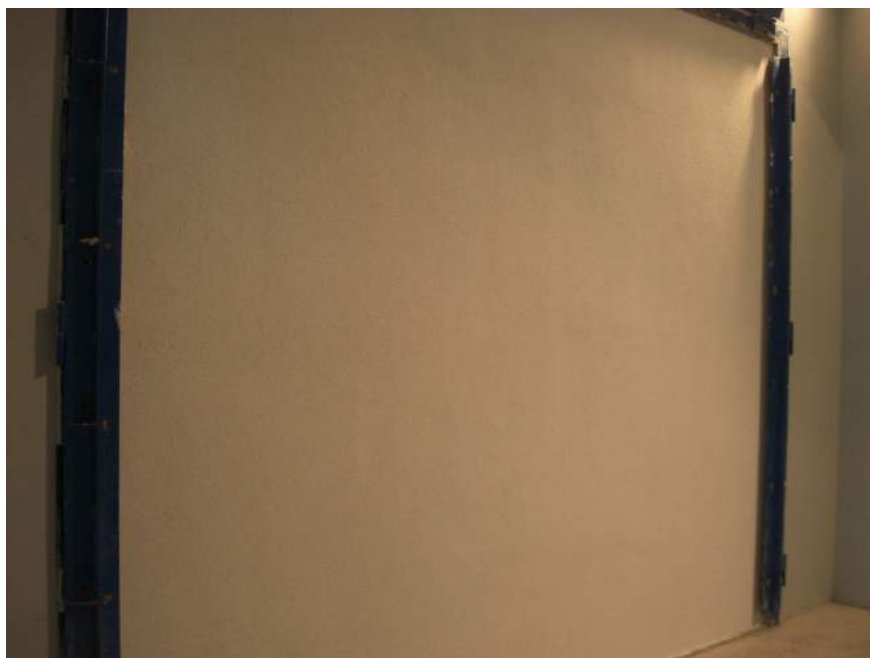
Muro con sistema TERMOK8 ® lato camera emittente
