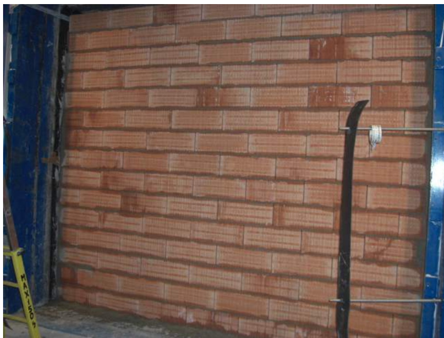
Muro senza intonaco lato camera ricevente
