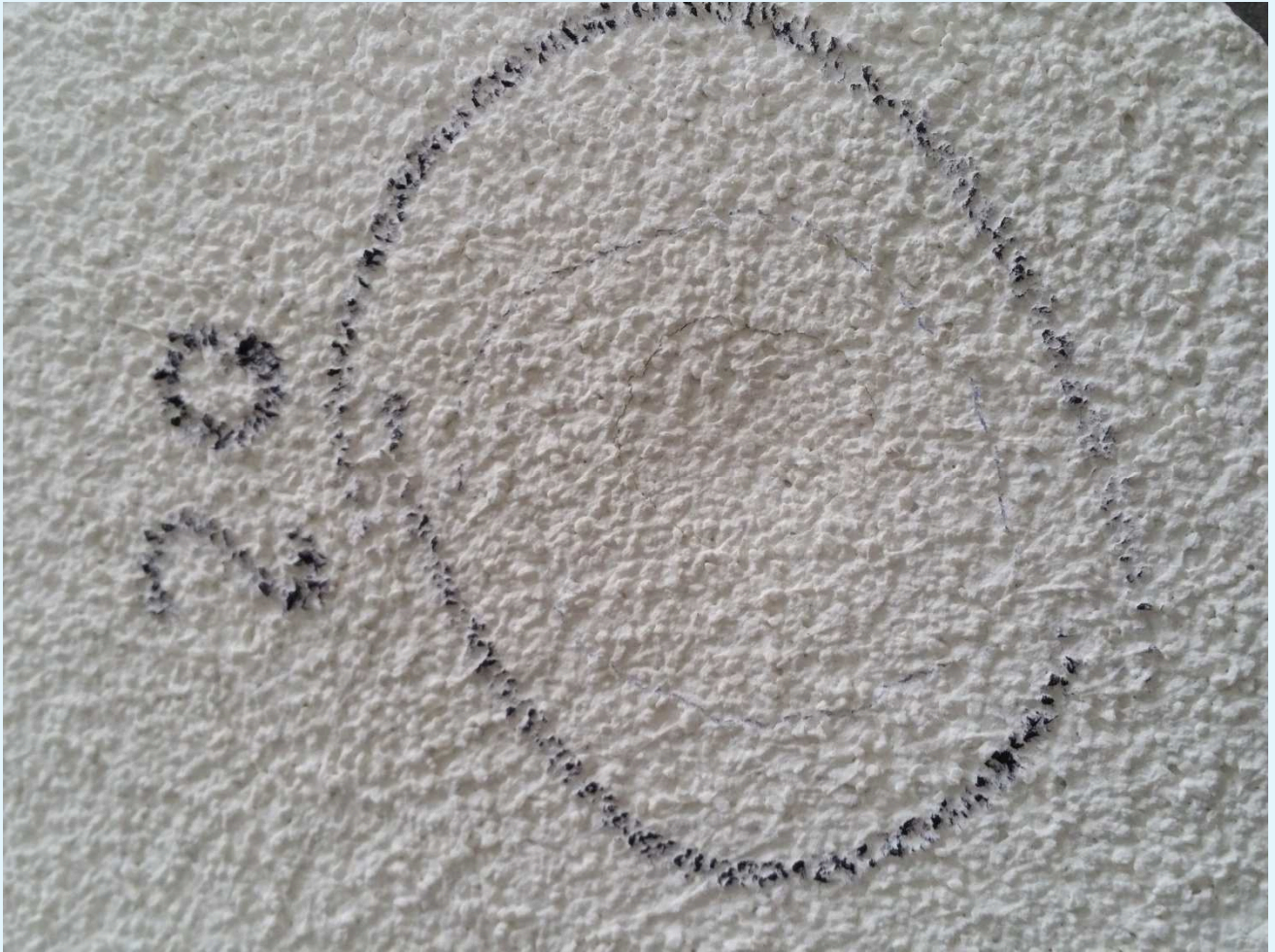
Esempio di ammaccatura con leggera screpolatura superficiale con urto di energia 20 J.
